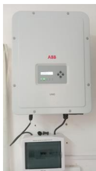
Figura 4, Imagen del inversor correspondiente a la instalación FV.
